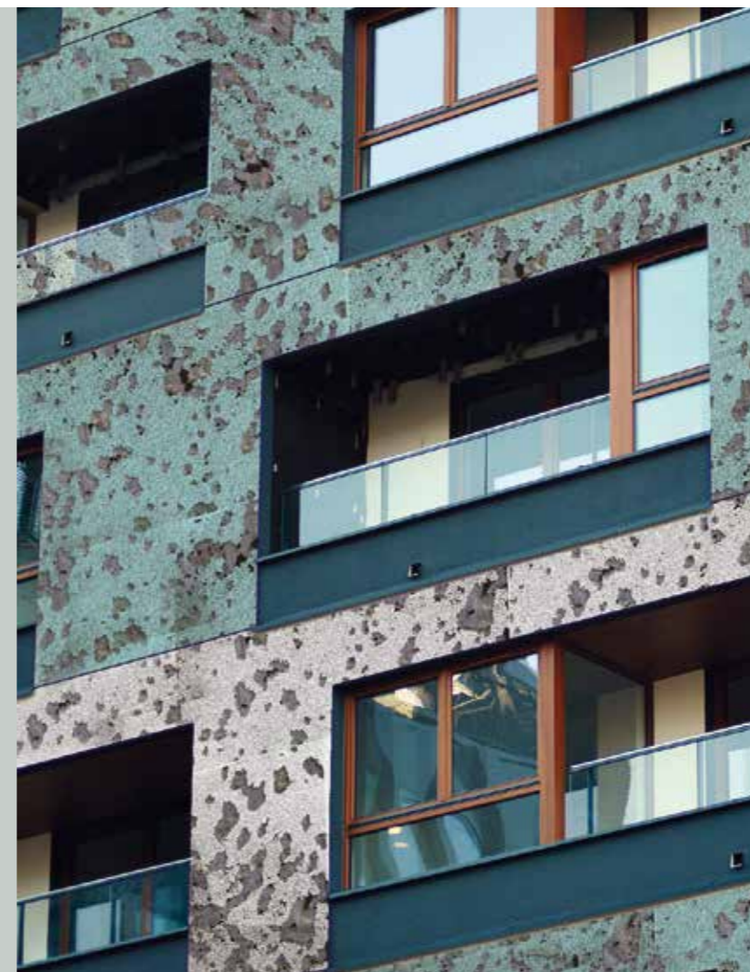
Grêle sur système d'isolation thermique
